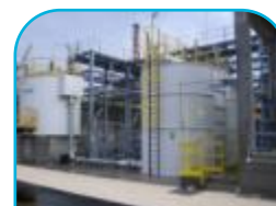
Densadeg™ en Terciario
