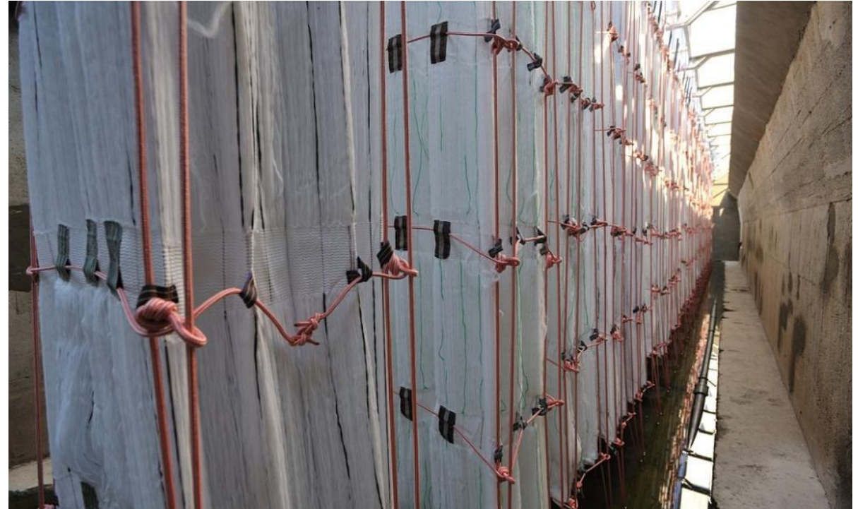
Soporte artificial instalado dentro de las reactores
