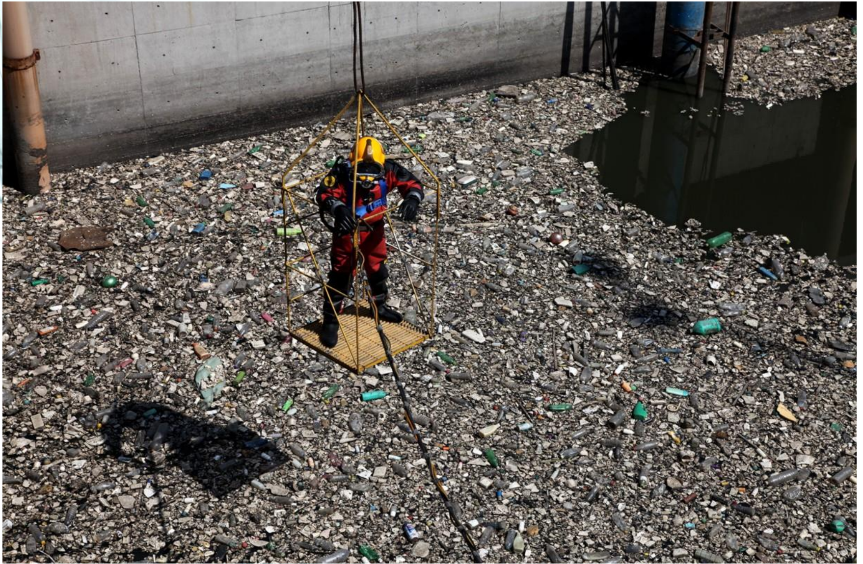
LLEGADA AL CARCAMO DE SUCCION DE LA PLANTA DE BOMBEO 18+500
