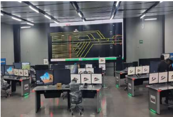
Centro de control
